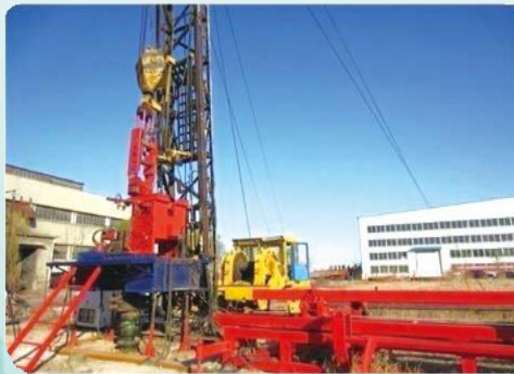
Minor Workover Avtomatlaşmış Sistem
